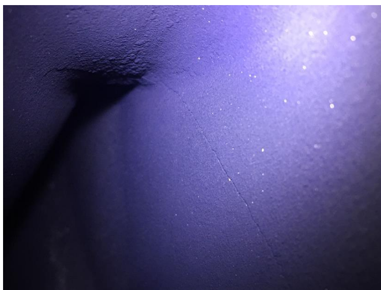
Рисунок 7 – Трещина в улитке турбины
